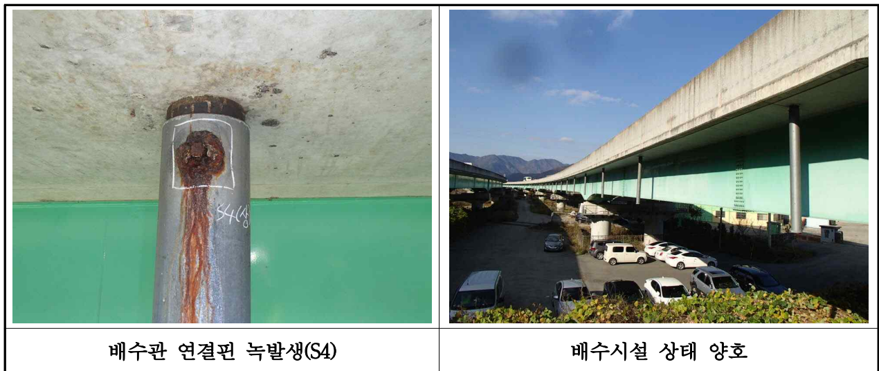
【사진 3.2.19】 배수시설 손상현황(대구)
