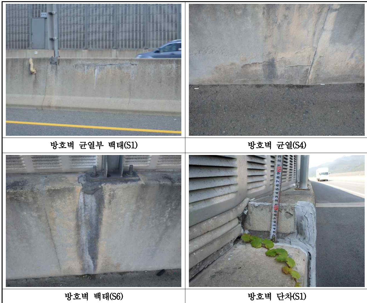
【사진 3.3.21】 방호벽 손상현황(부산)
