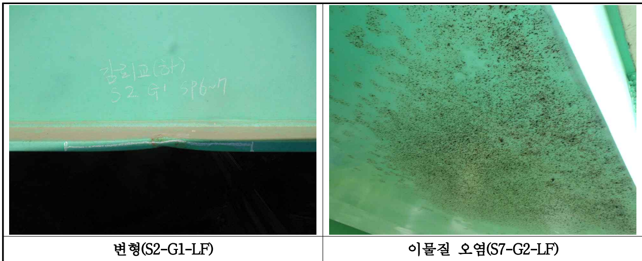
【사진 3.2.5】강박스 거더 외부 손상현황(대구, 계속)
