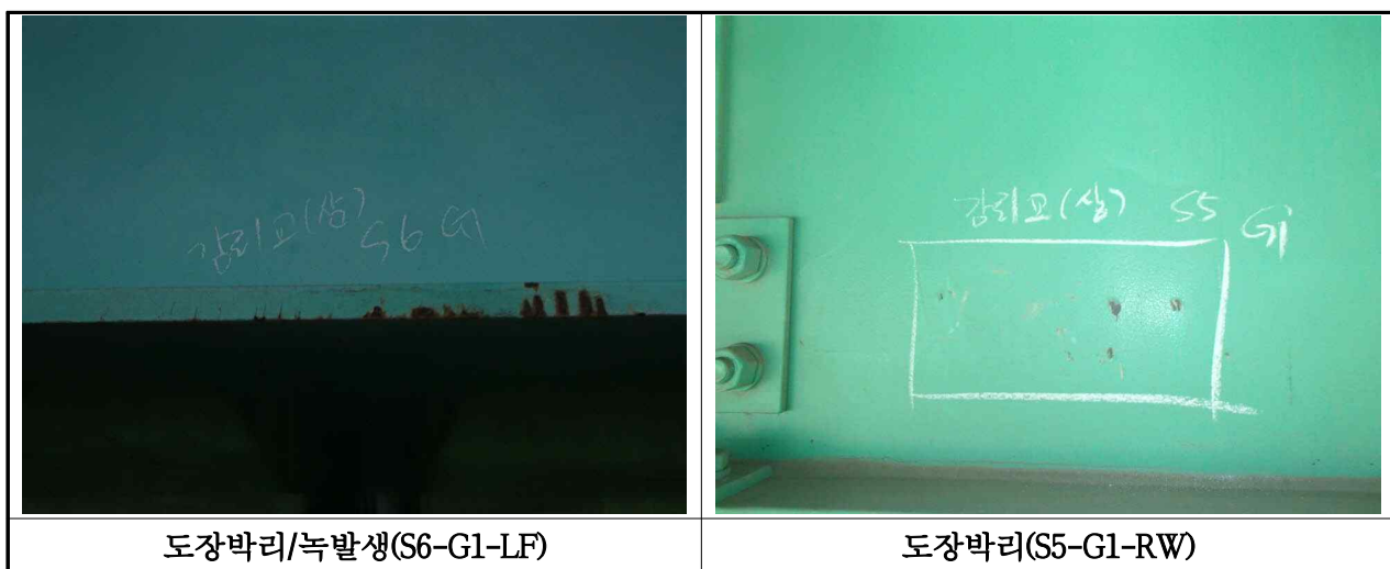
【사진 3.2.5】 강박스 거더 외부 손상현황(대구)
