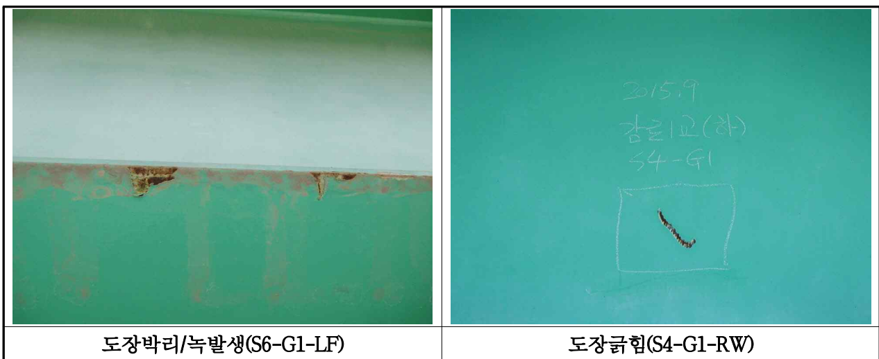
【사진 3.3.5】 강박스 거더 외부 손상현황(부산)
