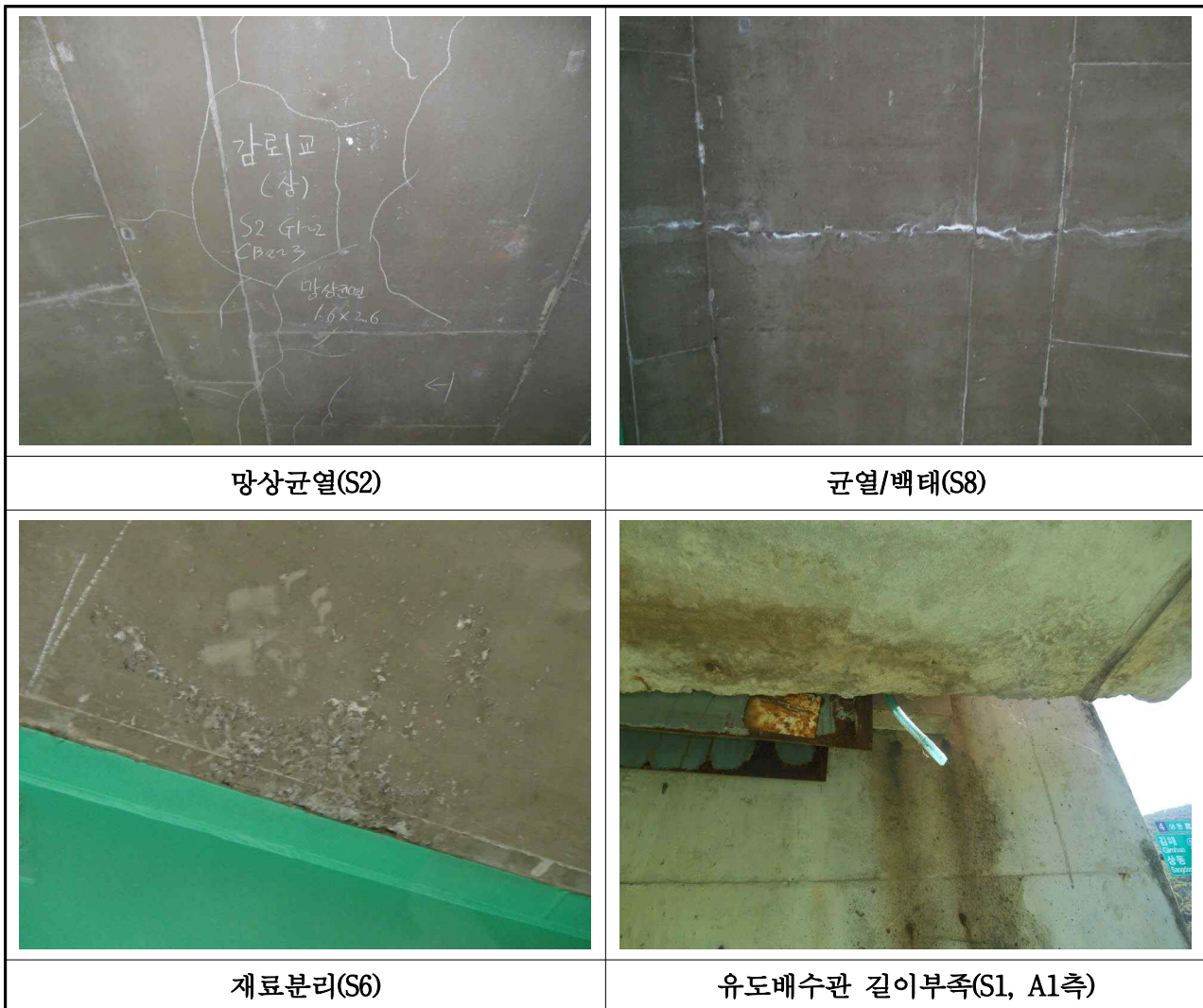
【사진 3.2.2】 바닥판 손상현황(대구)
