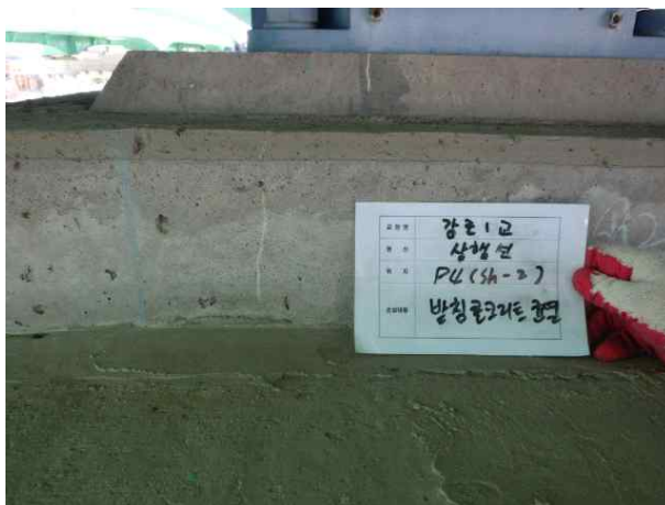
받침 콘크리트 0.2mm이하 균열(P4-Sh2)
