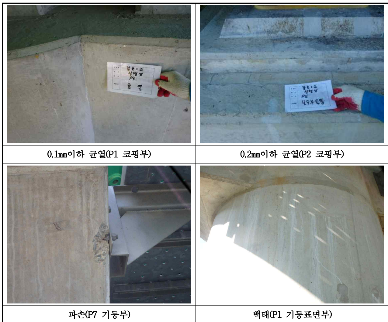
【사진 3.2.10】 교각 손상현황(대구)
