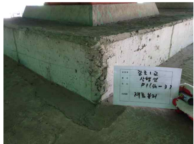
받침 콘크리트 재료분리(P1-Sh3)
