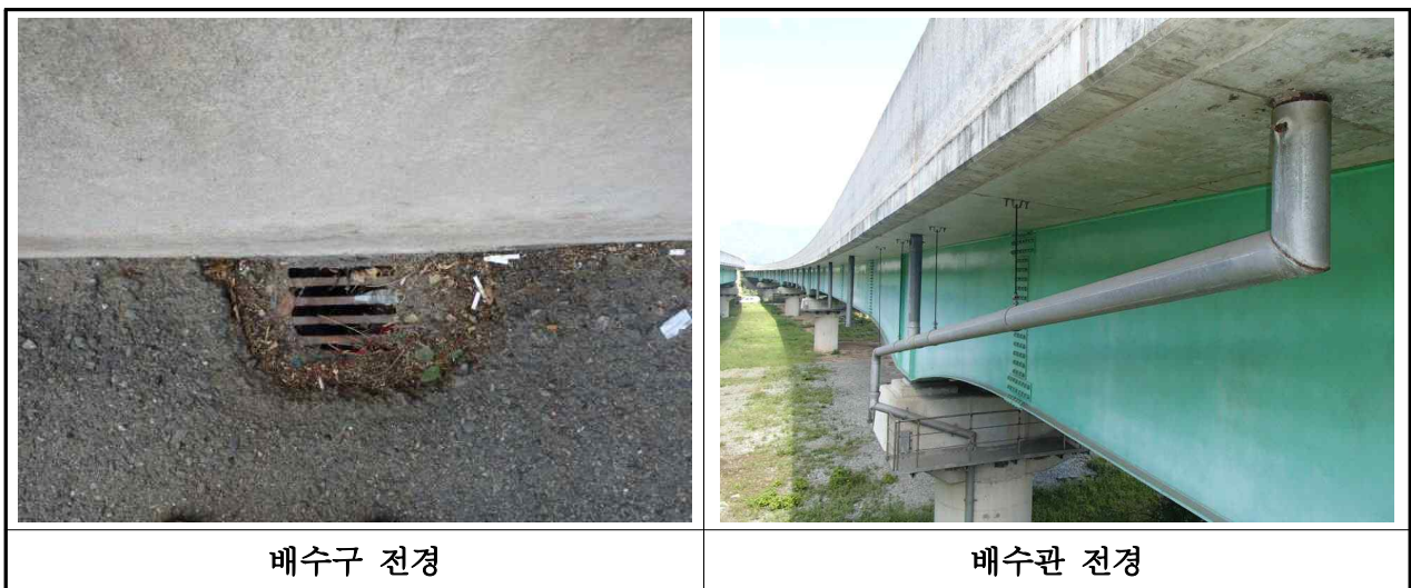
【사진 3.2.18】 배수구 및 배수관 전경(대구)
