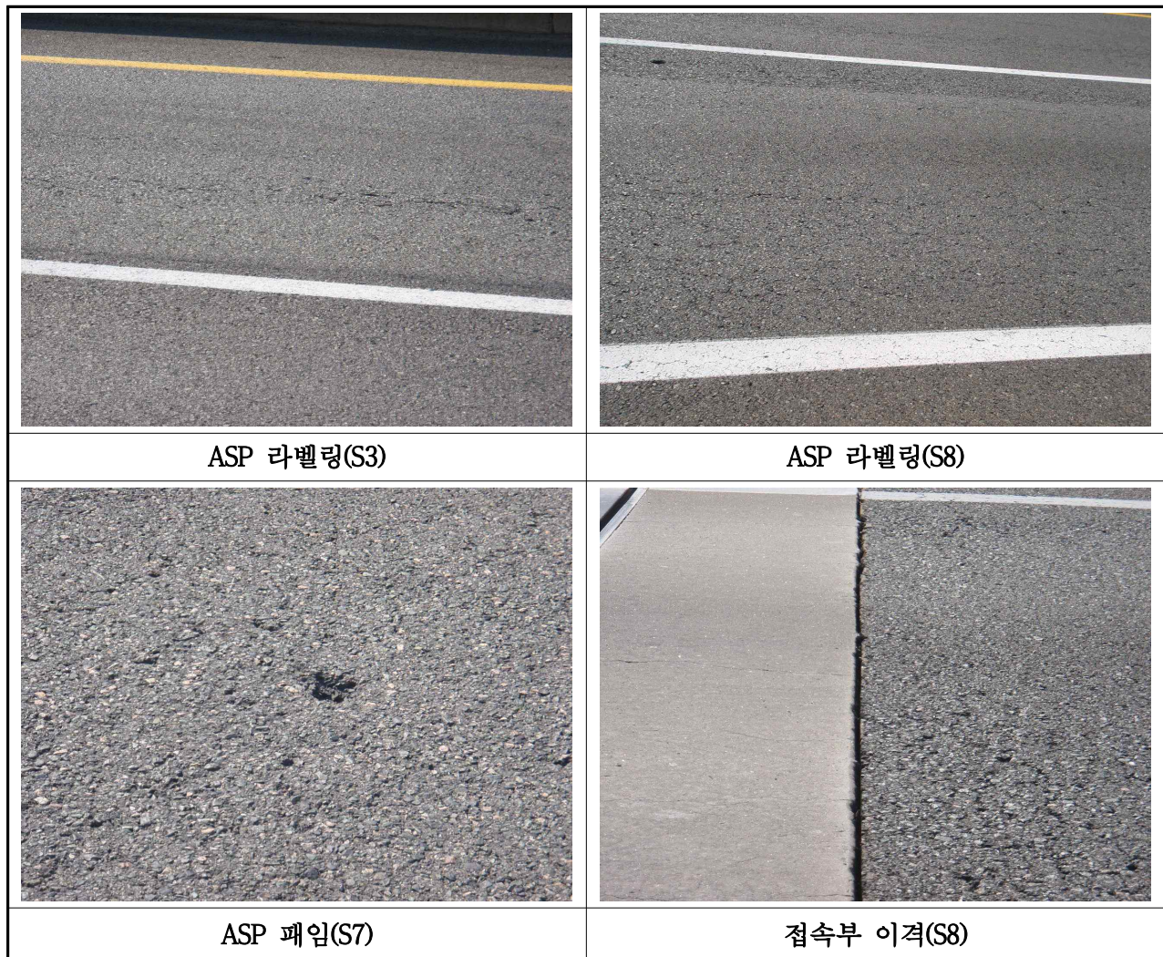
【사진 3.2.17】 교면포장 손상현황(대구)
